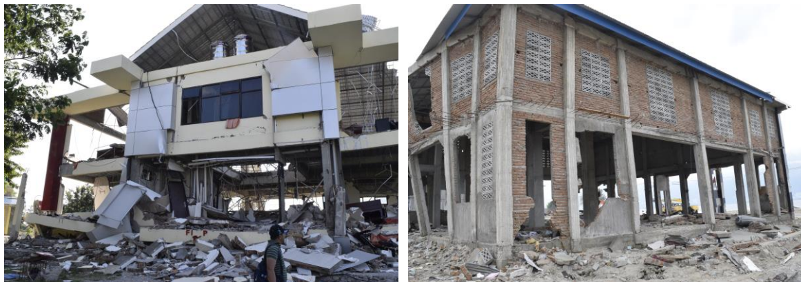
Gambar 3. Kerusakan Bangunan Beton Bertulang Akibat Gempa 2018
