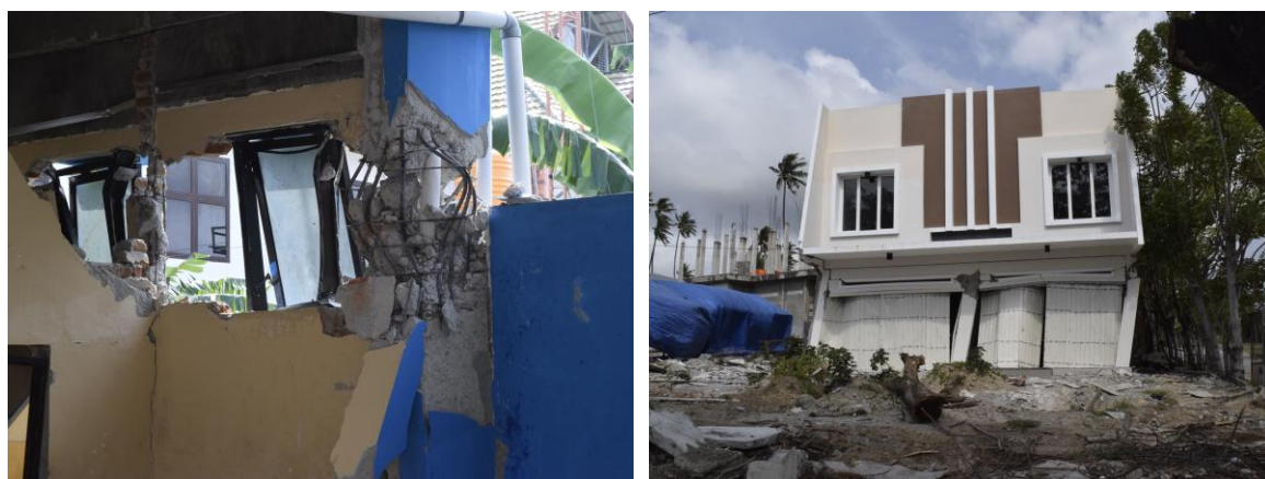
Gambar 7. Kerusakan Akibat Adanya Dinding Pengisi
