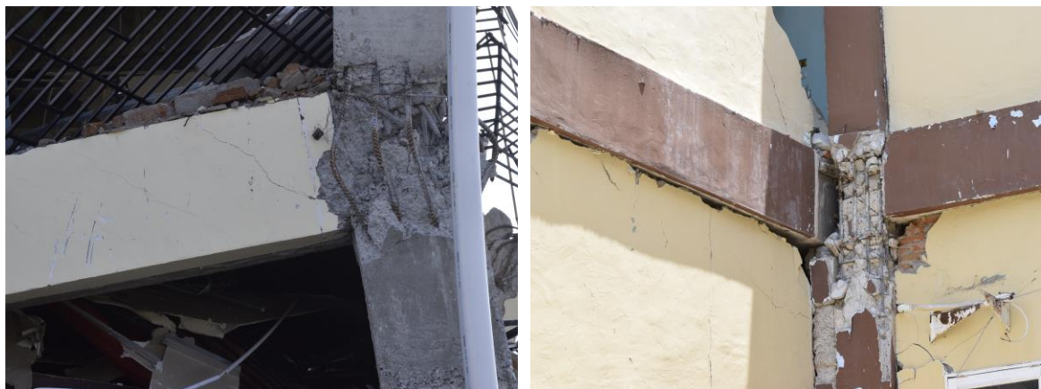
Gambar 6. Detailing Sambungan Balok-Kolom Yang Tidak Memadai
