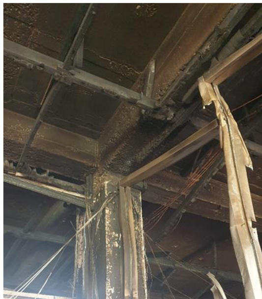
Gambar 4. Kondisi Struktur Pasca Kebakaran
