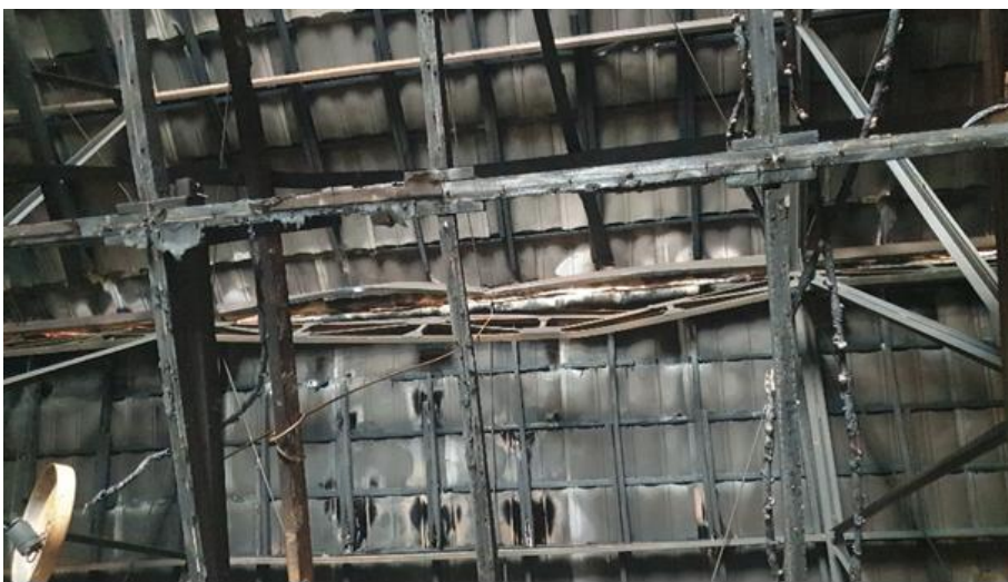
Gambar 7. Kondisi Elemen Struktur Atap Pasca Kebakaran (Lendutan)
