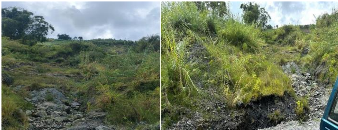
Gambar 1. Kondisi lereng setelah longsor
