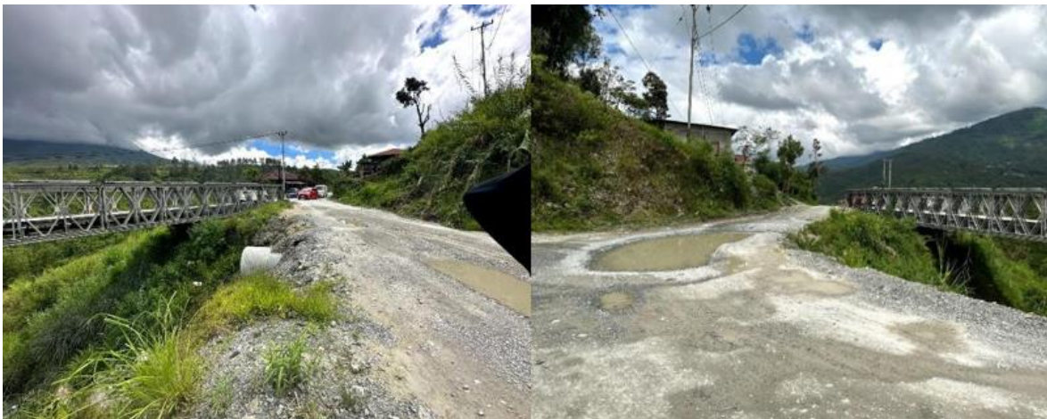
Gambar 2. Kondisi jalan sesudah longsor
